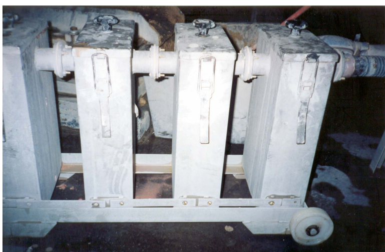
Conjunto de 4 Filtros "M" montados em série, em linha de barbotina
